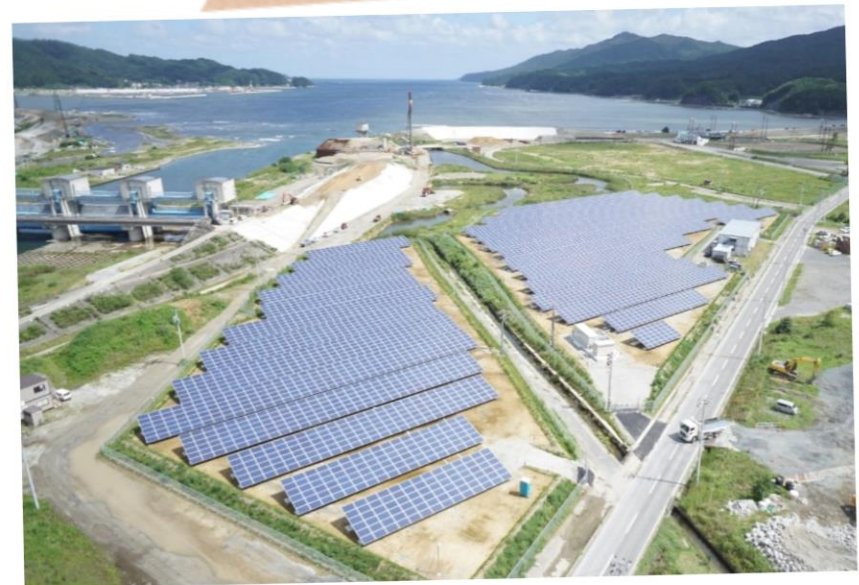
津軽石太陽光発電所
