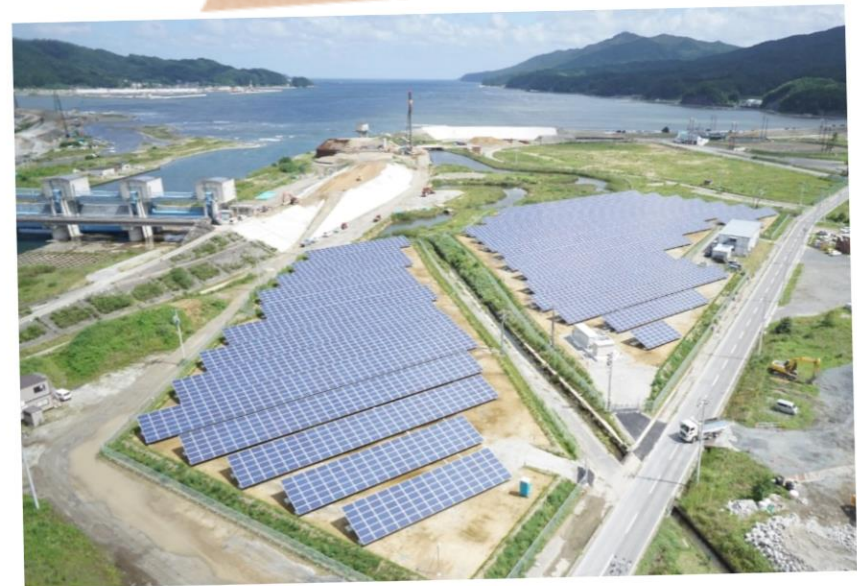
津軽石太陽光発電所
