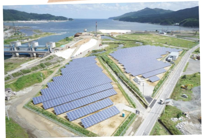
津軽石太陽光発電所
