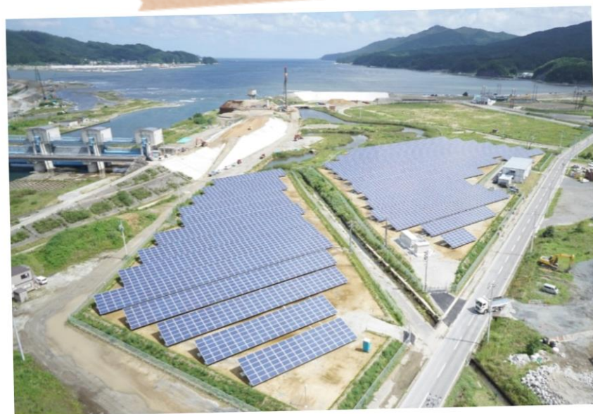
津軽石太陽光発電所
