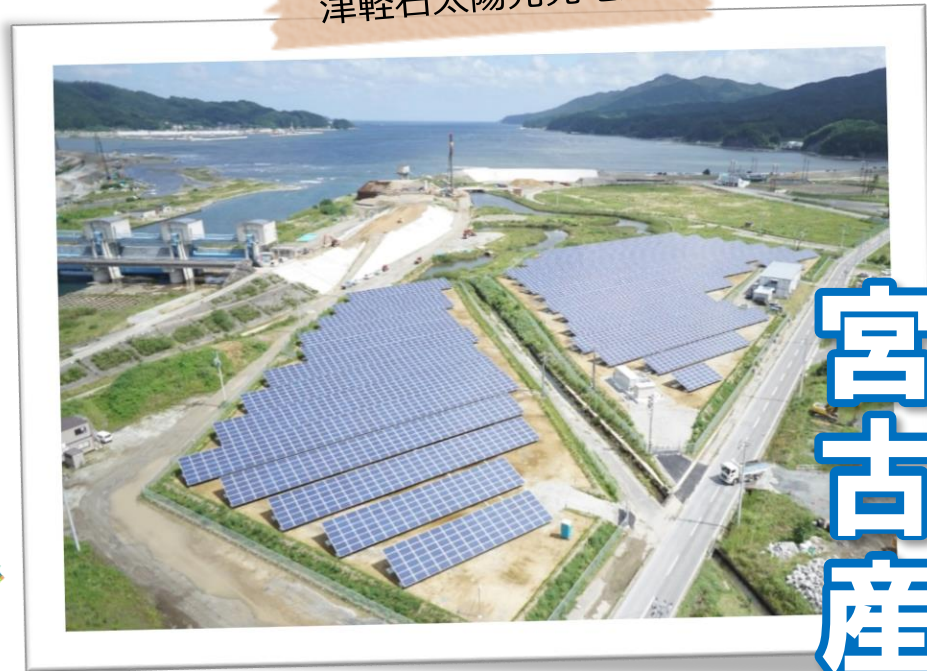
津軽石太陽光発電所
