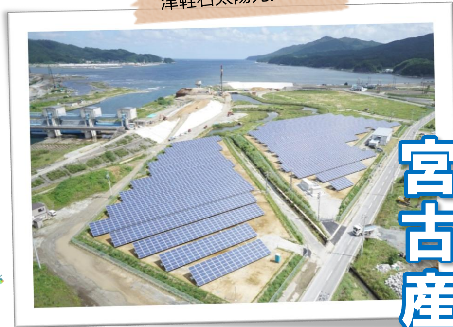
津軽石太陽光発電所
