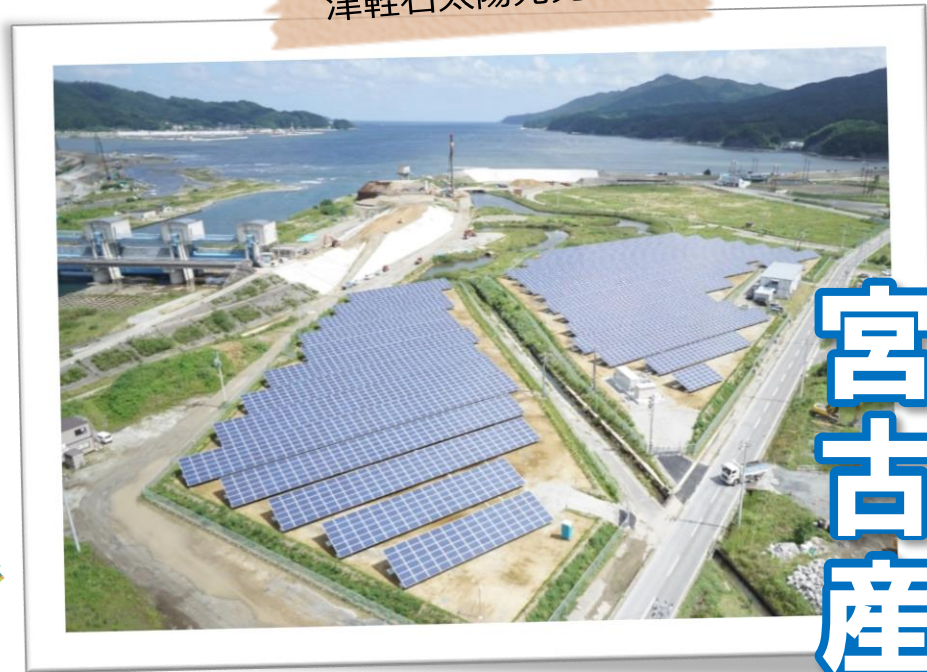
津軽石太陽光発電所
