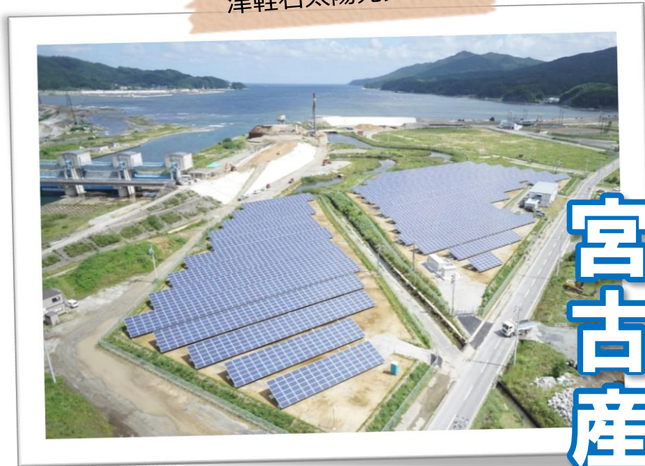
津軽石太陽光発電所
