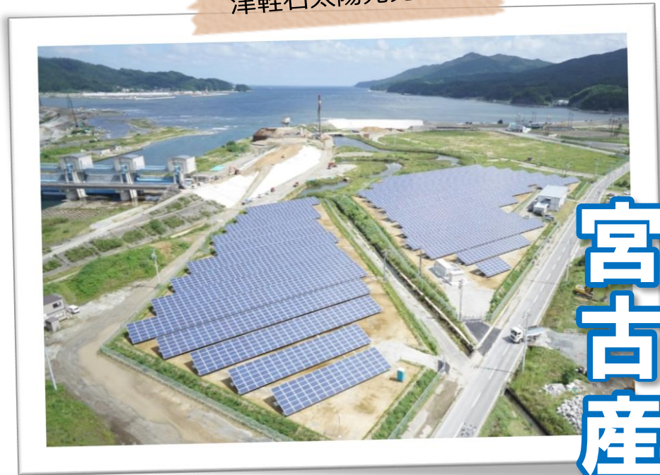
津軽石太陽光発電所
